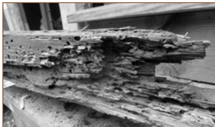
Aktuální stav nosného roštu (zcela dožilý a havarijní)
